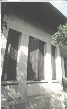
La Cité Fillod de Florange se compose de maisons "tout acier" de différents modèles.
